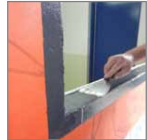
14. Permita que VaproLiqui-Flash seque al tacto, inspeccione por posibles vacíos y aplique mas VaproLiqui-Flash según necesidad, hasta lograr una cobertura completa.
