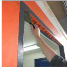
13. Inmediatamente esparza el material aplicado en todas las superficies hasta que estén completamente cubiertas y que el substrato inferior no sea visible (aproximadamente una capa húmeda de 12 a 15 mils).
